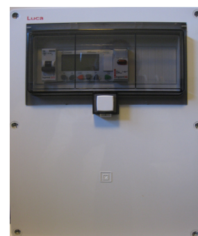
Styrskåp med PLC
